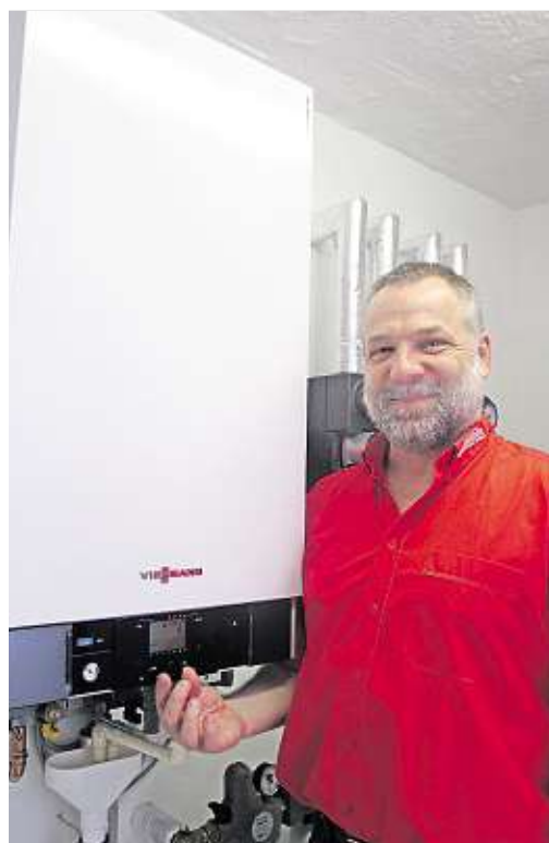
Ekkehard Grafe vor der Mikro-KWK-Anlage im Keller des Firmensitzes. Foto: S. Rehak
